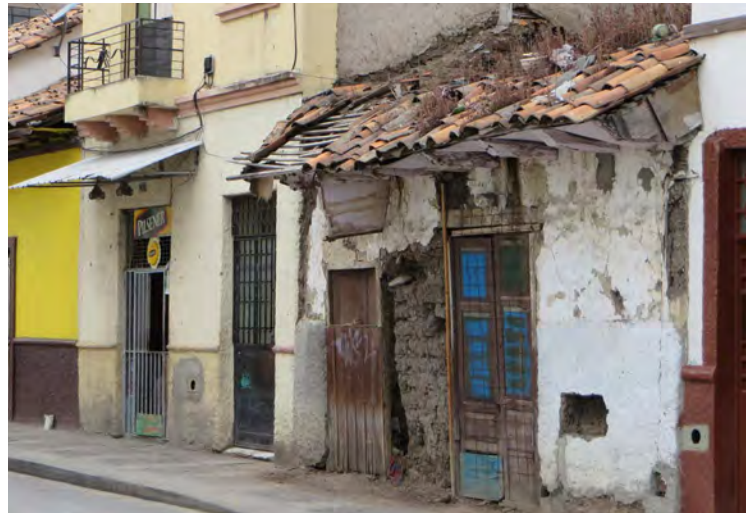
Inmueble en ruina en el Centro Histórico (ES)
