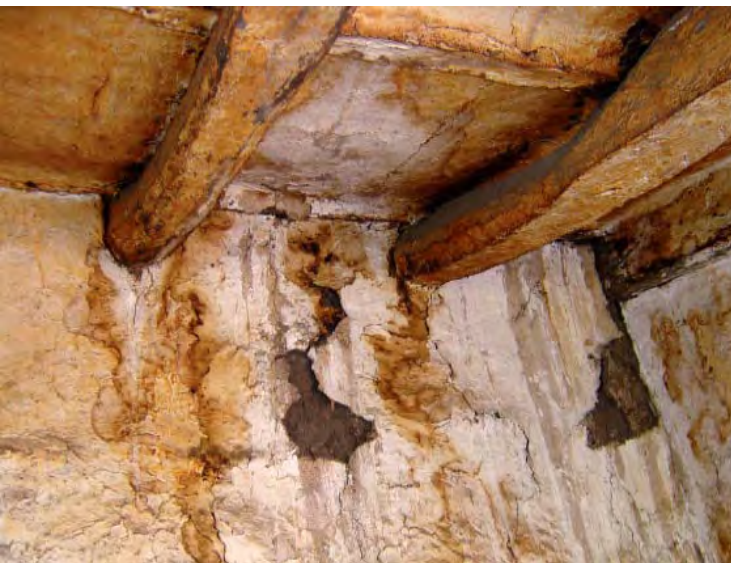
Infiltración de agua desde la cubierta (DP)
