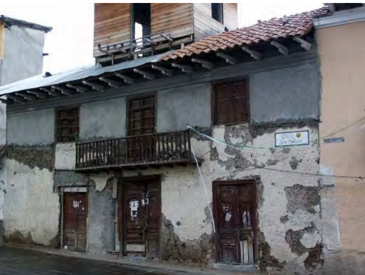
Muro de adobe con desprendimiento del revoque estanco (LA)
