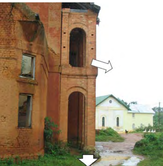
Desplome por asentamiento del suelo (con agua atrapada) en Madagascar, (SM)
