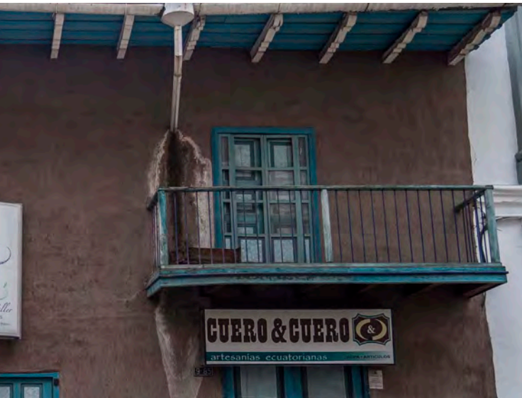
Bajante en mal estado dentro del muro genera fuga de agua. (LA)
